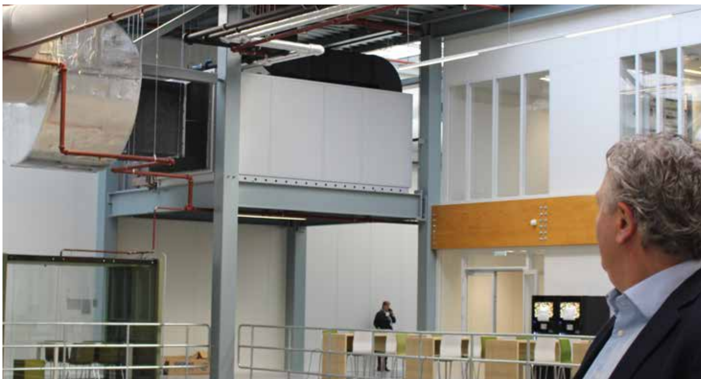
Een Systemair HHFlex luchtbehandelingsunit voorziet per XL-box in de specifieke klantwensen. Op de foto duidelijk zichtbaar de open structuur, kenmerkend voor BIC.
