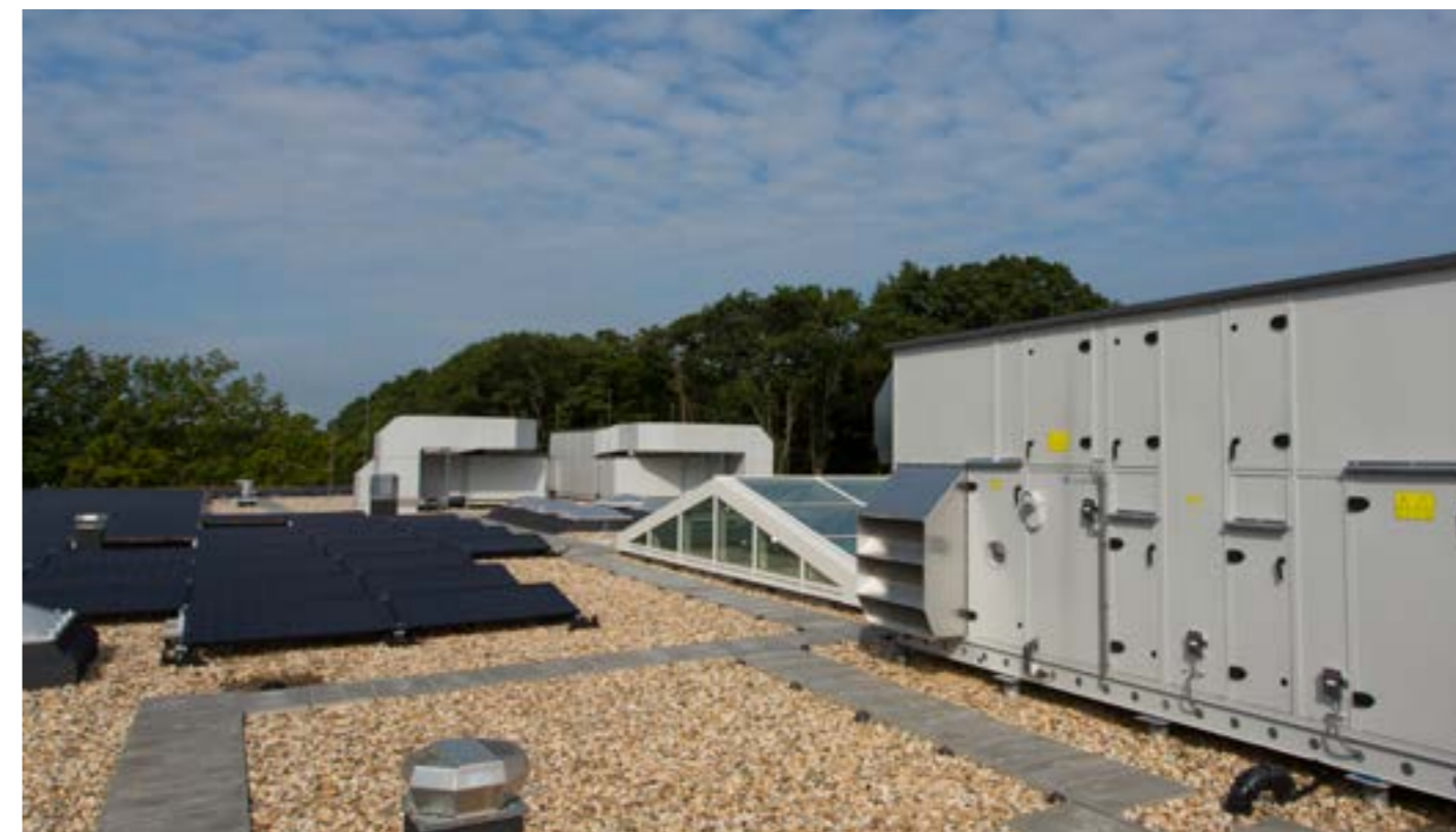
Op het dak staan ook Systemair dakventilatoren die zorgen voor de afzuiging van de toiletgroepen, de keuken en de zuurkasten van de natuur- en scheikunde lokalen.
