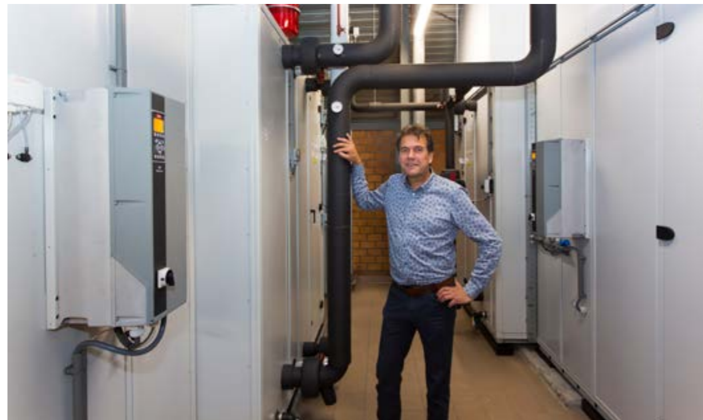
Door de toepassing van twincoil konden de afmetingen van de luchtbehandelingsunits beperkt blijven en paste het in de bestaande technische ruimte.
